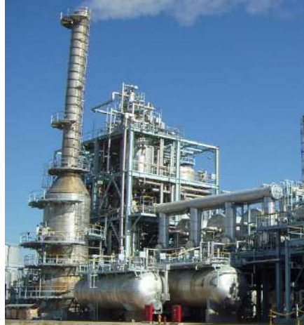
울산공장 PA Plant
