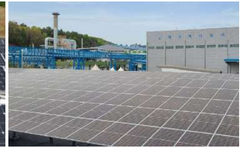
청양1공장 태양광 발전시설
