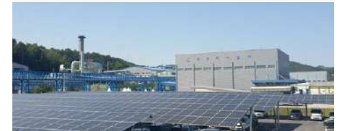
청양공장 태양광 발전시설
