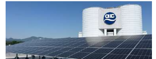
연구소 태양광 발전시설
