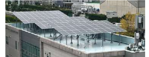
울산공장 태양광 발전시설
