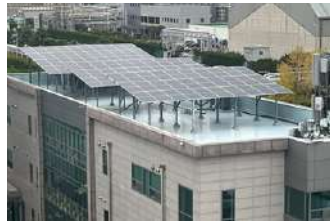
울산공장 태양광 발전시설
