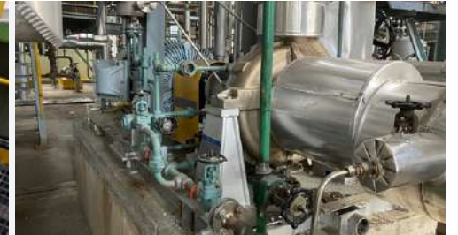
울산공장 열매체 펌프
