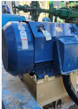
고효율 기기 설치
