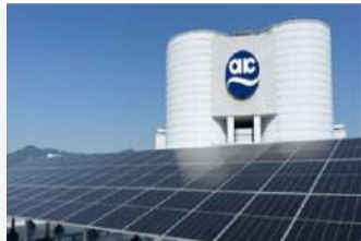
연구소 태양광 발전시설
