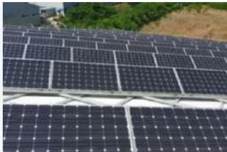
전주공장 태양광 발전시설
