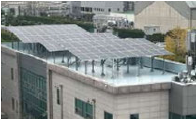
울산공장 태양광 발전시설
