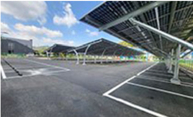
청양공장 태양광 발전시설
