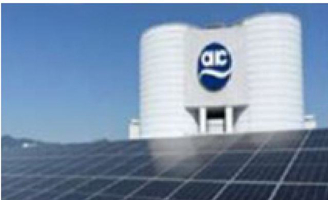
대전연구소 태양광 발전시설
