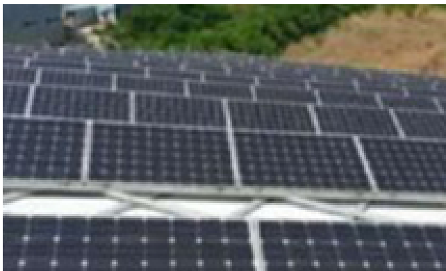
전주공장 태양광 발전시설
