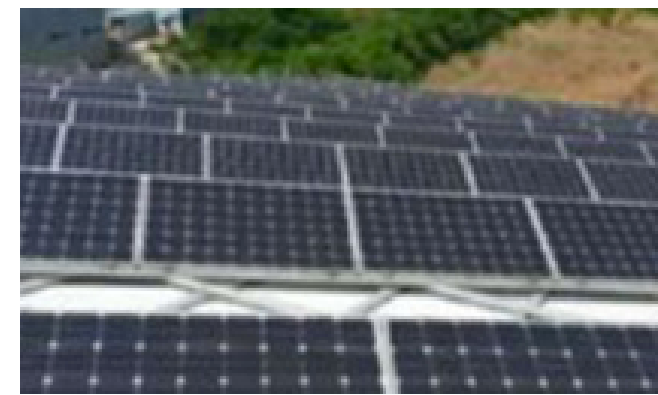
전주공장 태양광 발전시설
