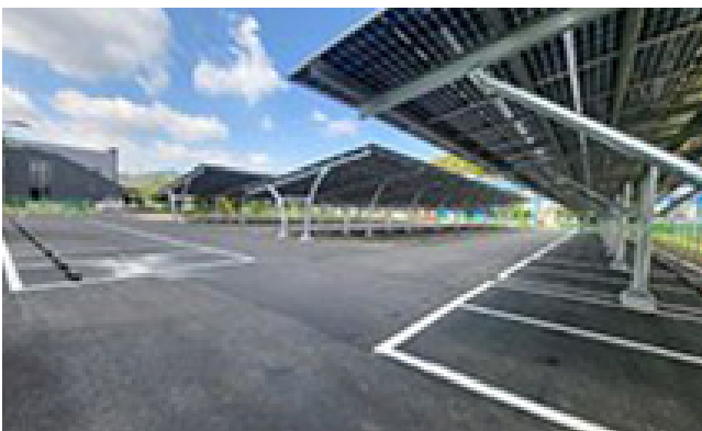
청양공장 태양광 발전시설
