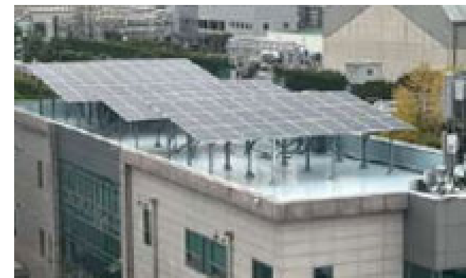
울산공장 태양광 발전시설
